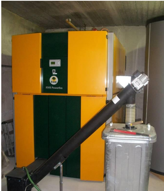
Biomasse - Heizkessel KWB POWERFIRE TDS 300 kW
